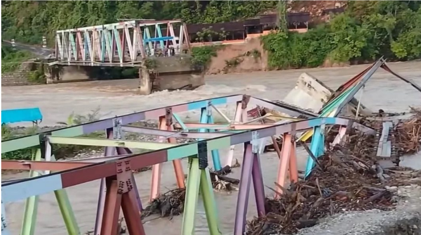
Kondisi memprihatinkan jembatan yang hancur akibat terjangan arus sungai yang deras.
