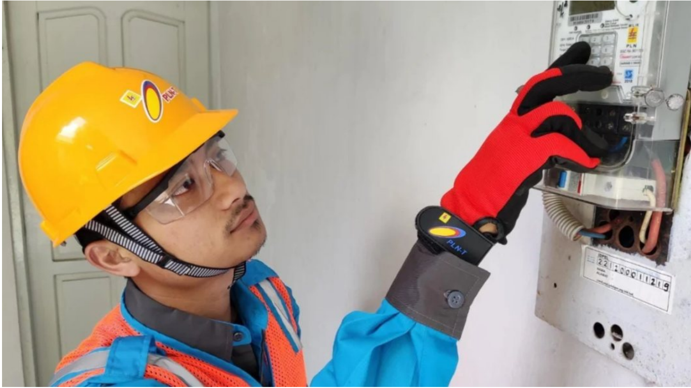
Petugas PLN melakukan pengecekan rutin pada meteran listrik untuk memastikan layanan energi yang optimal.
